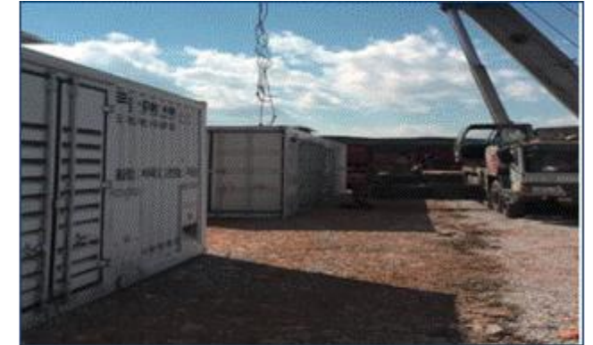
35kV/4MVA新能源测试平台
